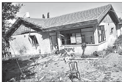
Жилой дом в Сдероте, поврежденный «кассамом»
